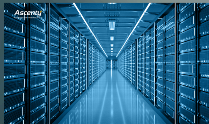
INFRAESTRUCTURA DE LOS 24 CENTROS DE DATOS
