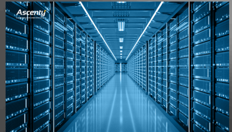
INFRAESTRUCTURA DE LOS 24 CENTROS DE DATOS
