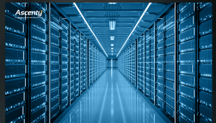
INFRAESTRUCTURA DE LOS 24 CENTROS DE DATOS
