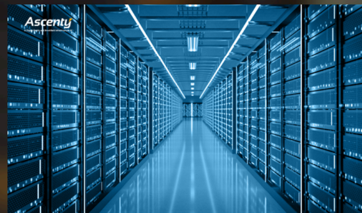
INFRAESTRUCTURA DE LOS 24 CENTROS DE DATOS
