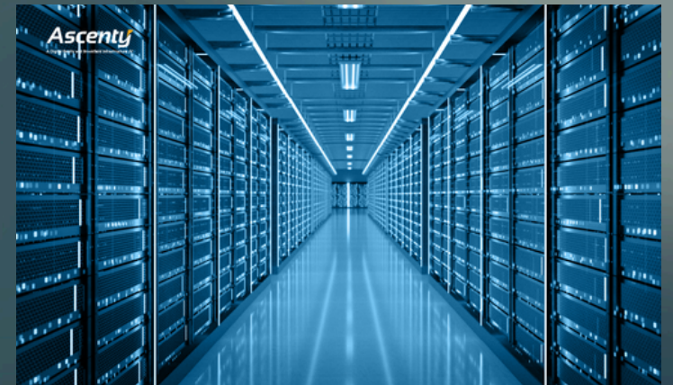
INFRAESTRUCTURA DE LOS 24 CENTROS DE DATOS
