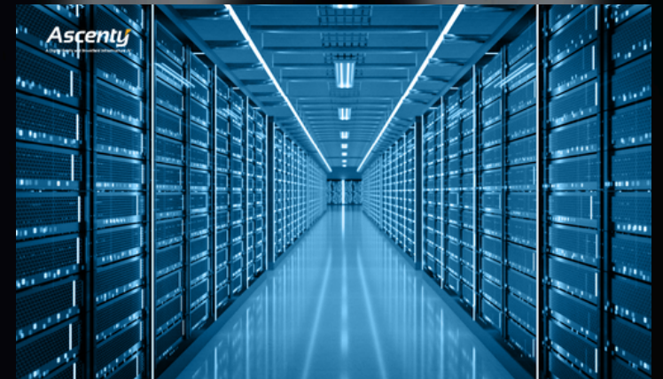
INFRAESTRUCTURA DE LOS 24 CENTROS DE DATOS
