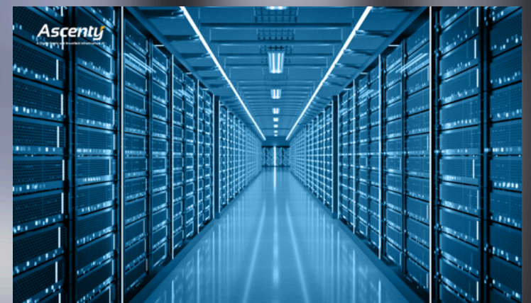
INFRAESTRUCTURA DE LOS 24 CENTROS DE DATOS
