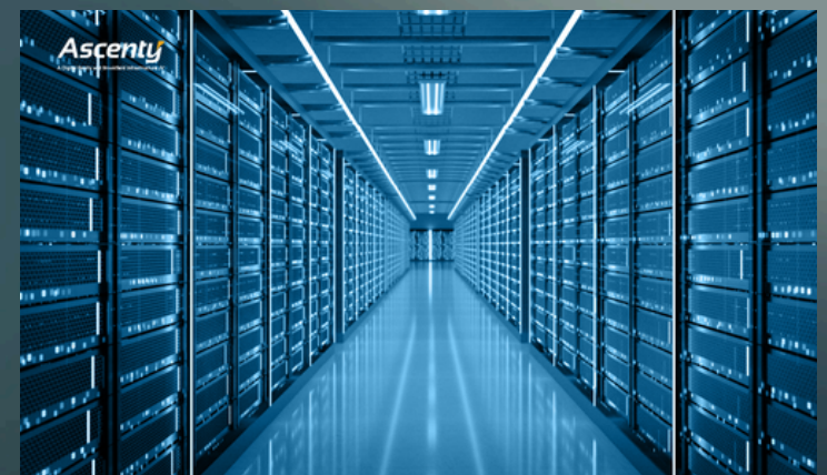
INFRAESTRUCTURA DE LOS 24 CENTROS DE DATOS
