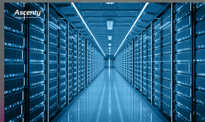
INFRAESTRUCTURA DE LOS 24 CENTROS DE DATOS
