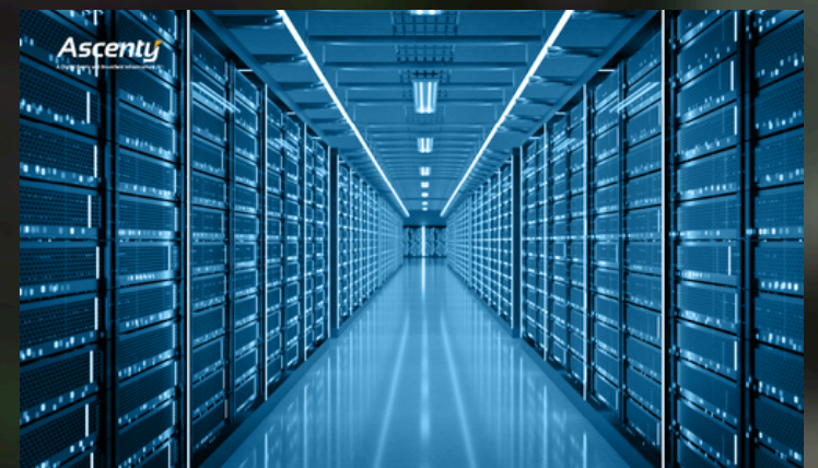
INFRAESTRUCTURA DE LOS 24 CENTROS DE DATOS
