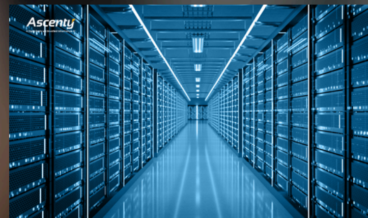
INFRAESTRUCTURA DE LOS 24 CENTROS DE DATOS
