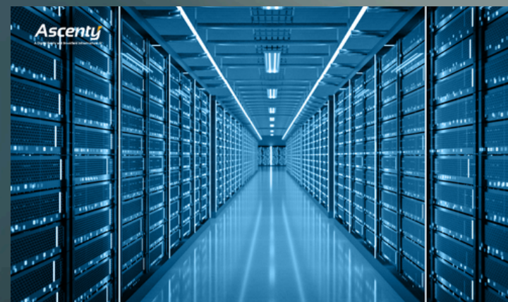
INFRAESTRUCTURA DE LOS 24 CENTROS DE DATOS
